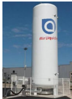
LNG cryogenics tank
